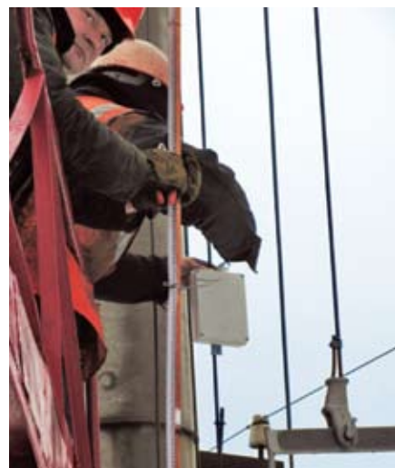
Рис.6. Установка системы непрерывного мониторинга контактной сети в опытную эксплуатацию
